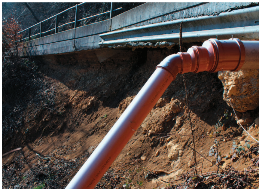
Der stark unterspülte Lampenbergerweg wird saniert.
